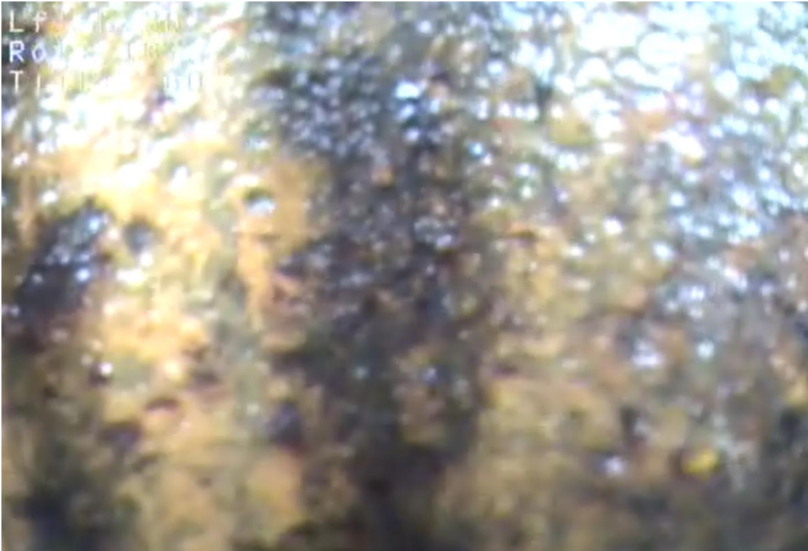
Dybde: 6,3 meter under terræn. Rustbelægninger og okker. Over rovandstanden.
