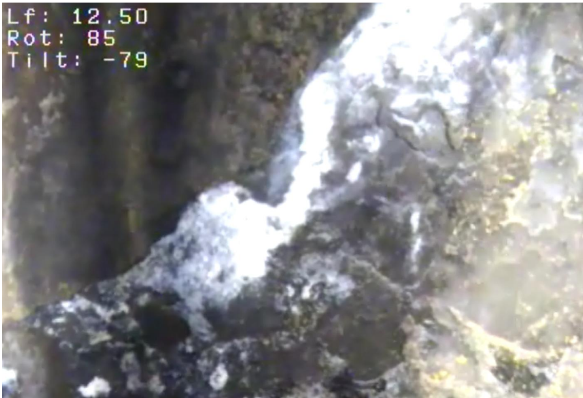
Dybde: 12,50 meter under terræn. Store belægninger af rustskaller. Større potentielle gennemtæring.
