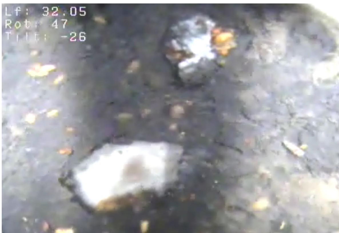
Dybde: 32,05 meter under terræn. Gennemtæring af stålør.
