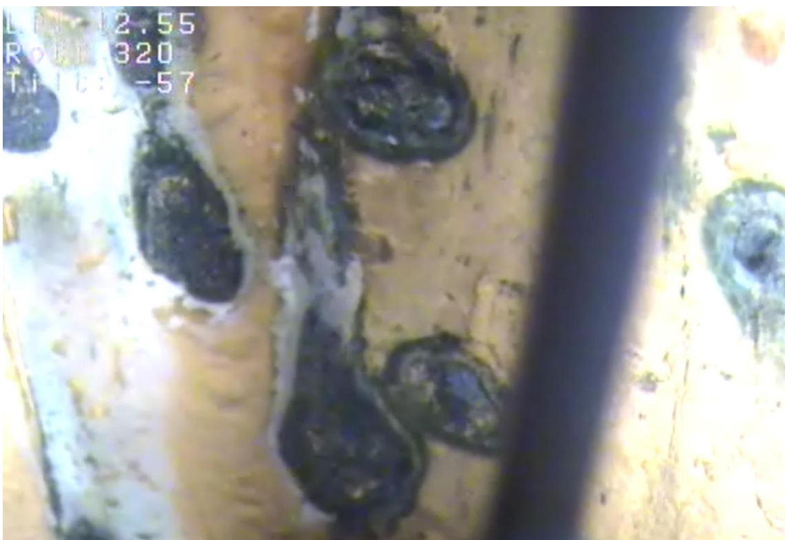
Dybde: 12,55 meter under terræn. Potentielle kommende gennemtæringer.
