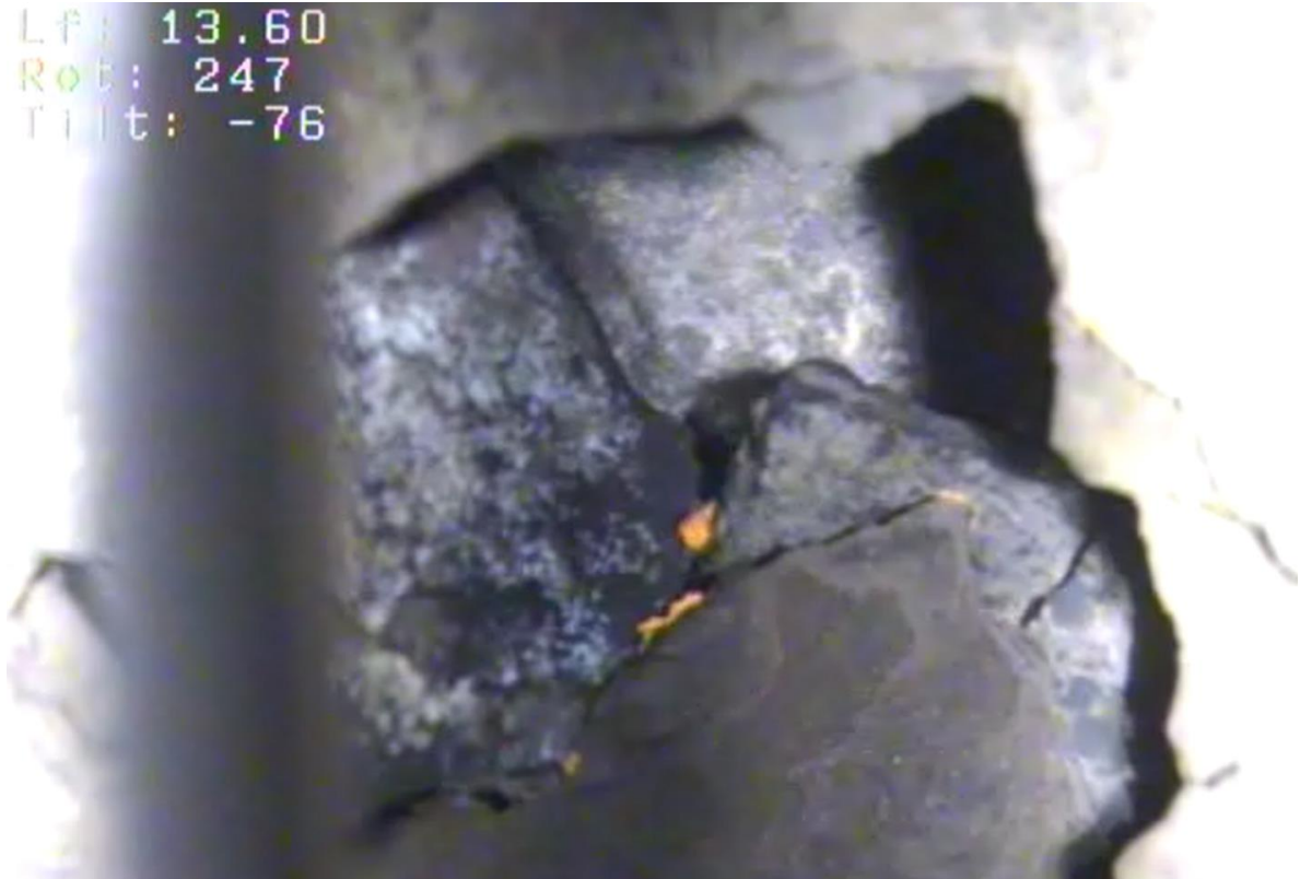
Dybde: 13,60 meter under terræn: Stor gennemtæring.
