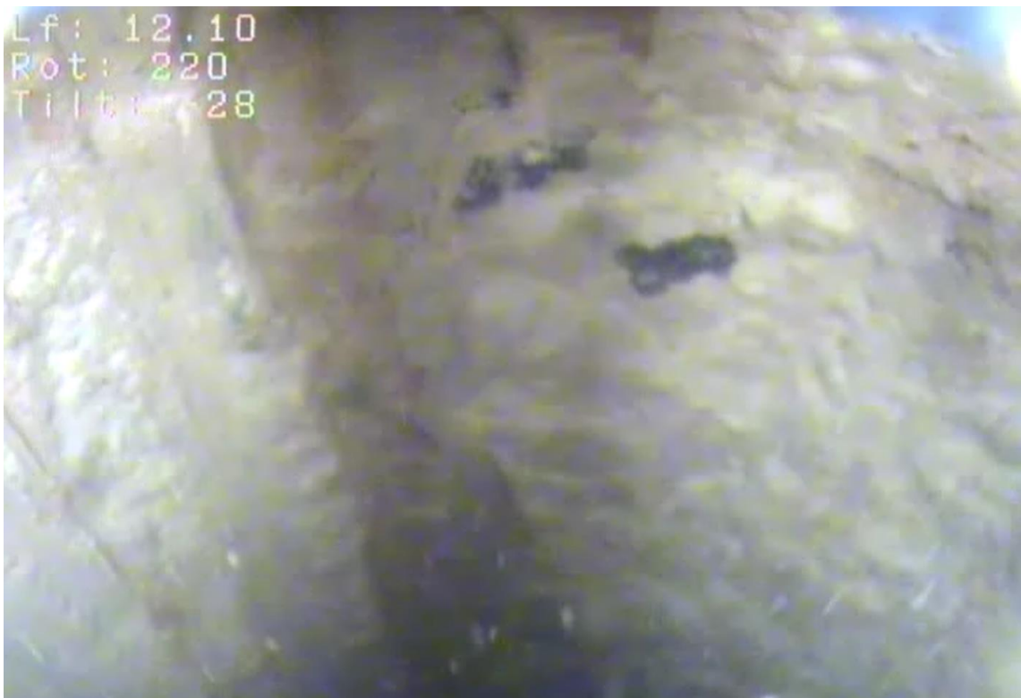
Dybde: 12,1 meter under terræn. Større belægninger af okkerslam.
