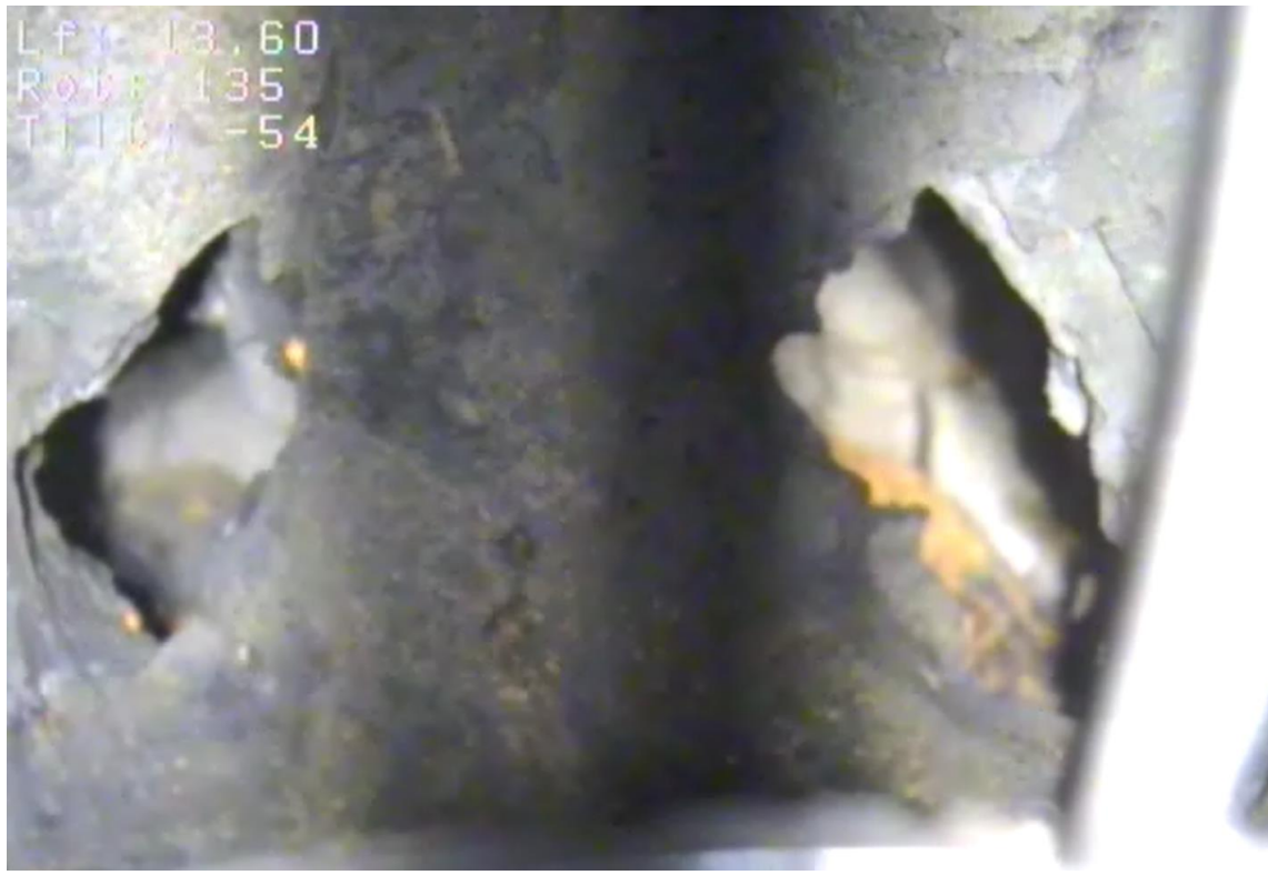
Dybde: 13,60 meter under terræn: Stor gennemtæring.
