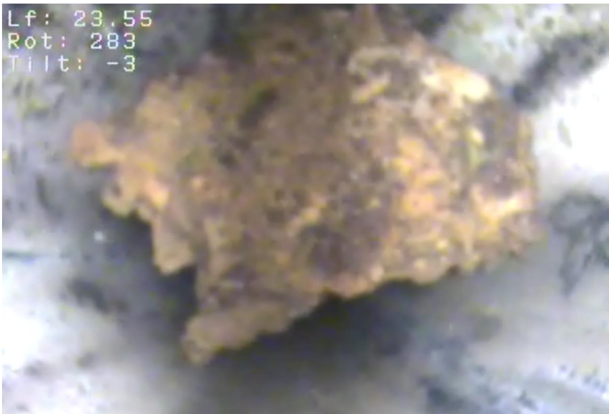
Dybde: 23,55 meter under terræn. Stor rustflange i boringshul.
