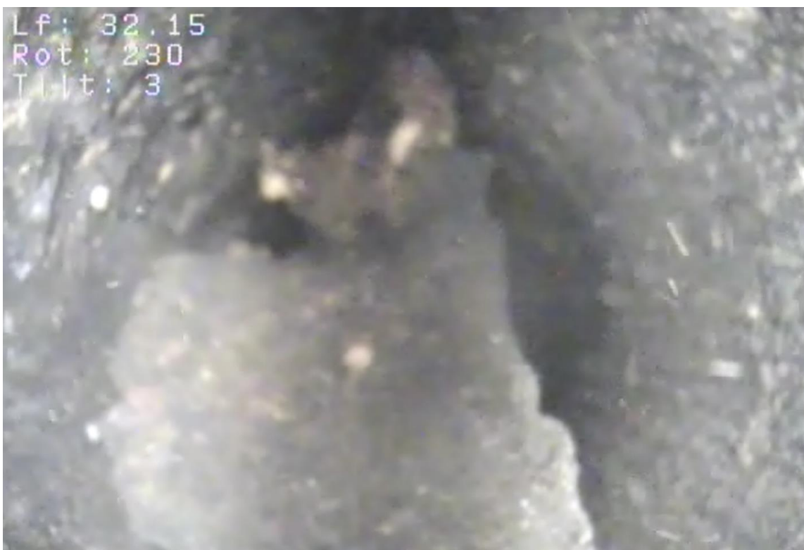
Dybde: 32,15 meter under terræn. Stor rustflange i boringshul. Generelt større mangan belægninger.
