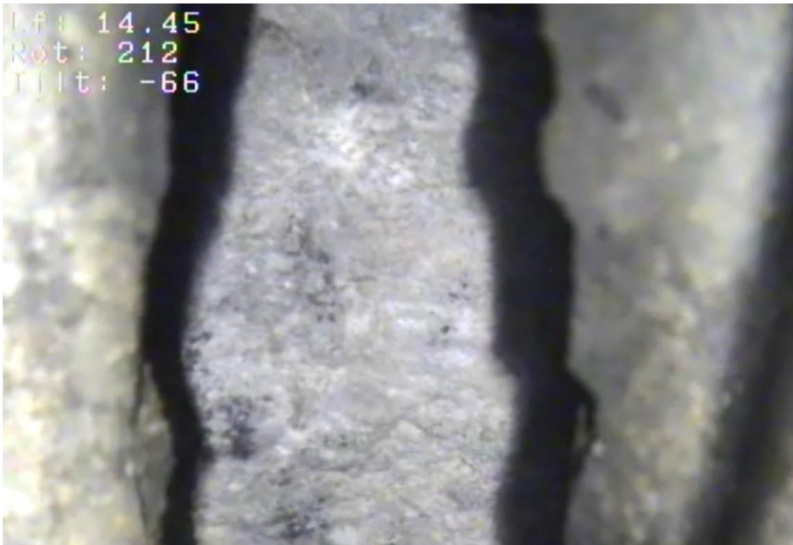
Dybde: 13,60 meter under terræn: Stor gennemtæring.
