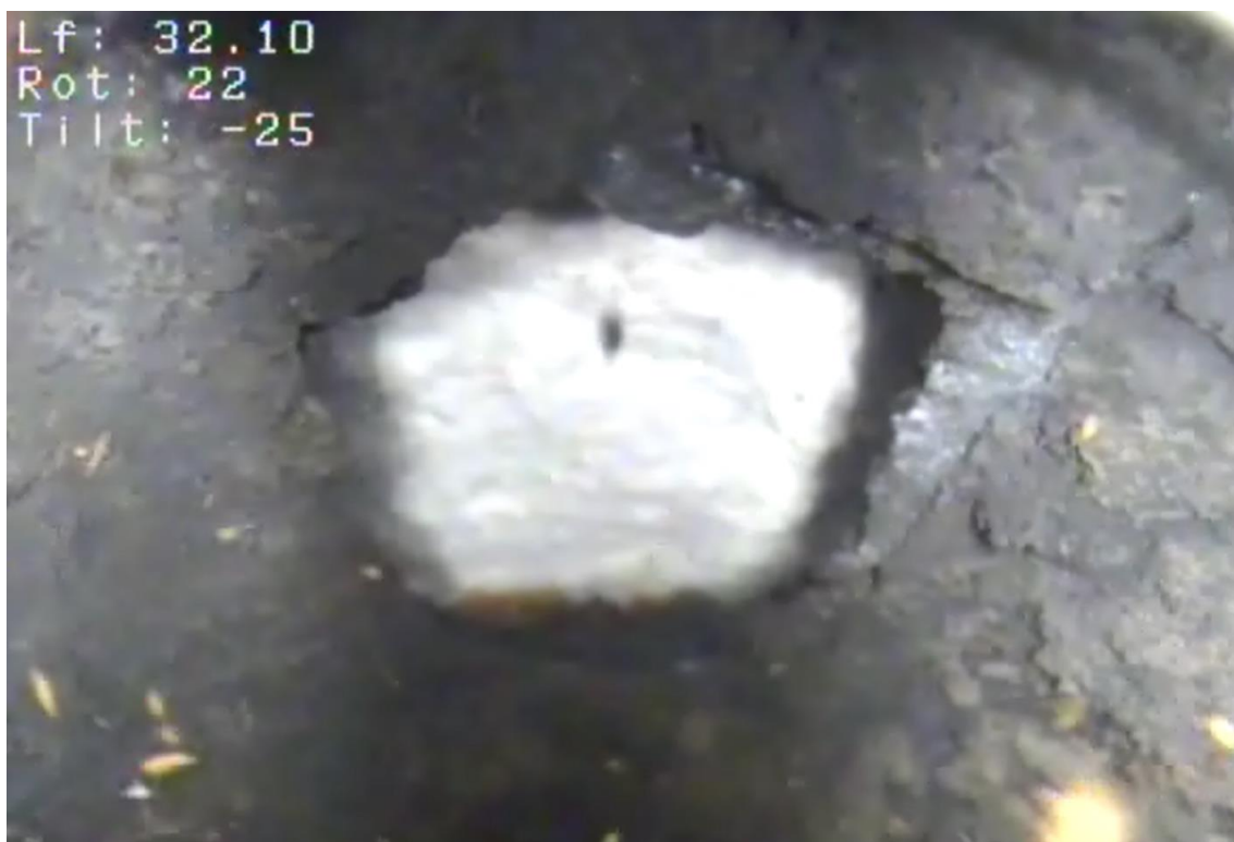
Dybde: 32,10 meter under terræn. Gennemtæring af stålør.
